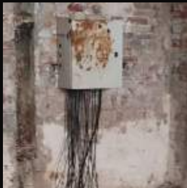
Goteras de cables
