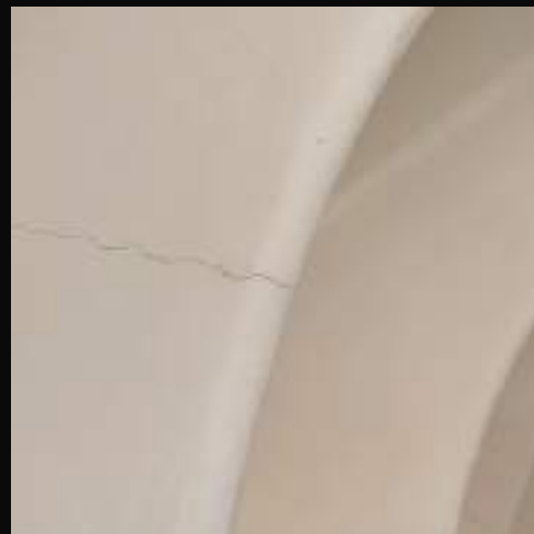
Grieta en arco
