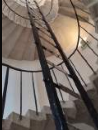
Escalera para subir por el centro de la escalera
