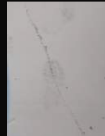
Huellas en la grieta
