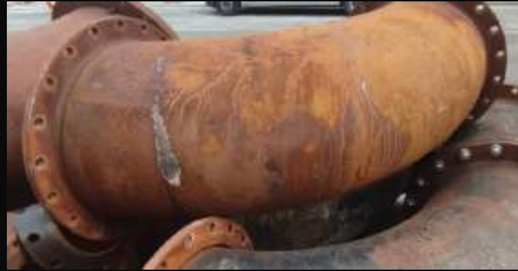
Rayos en las tuberías
