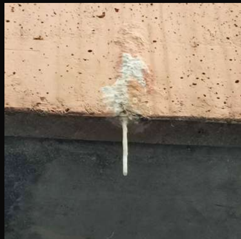
Estalactita de hormigón
